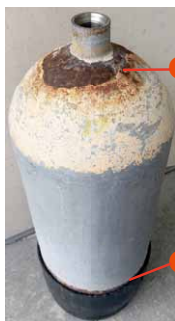
① タンク外側がサビていないか
